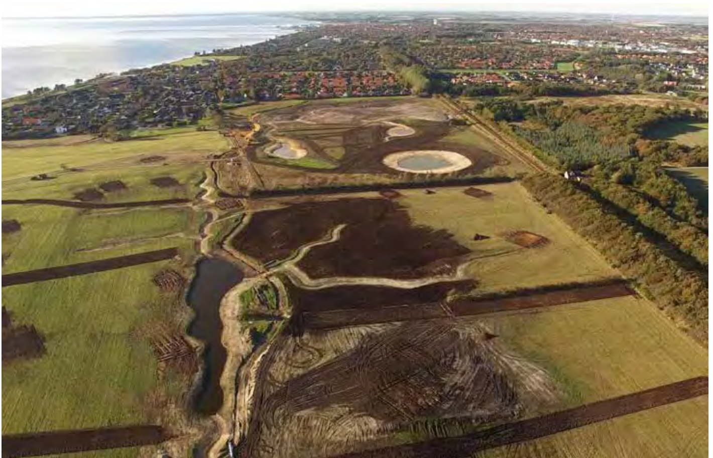
I 2015-16 omdanner Ringkøbing K det tidligere landbrugsareal til et rekreativt naturområde, før husene i bydelen kan bygges. Samtidig med udviklingen af naturen bliver hele bydelen klimatilpasset. Luftfoto fra anlægsarbejdet, oktober 2015.
